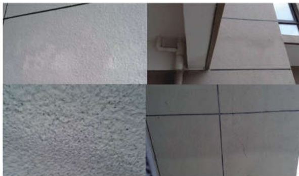
» 常见涂料施工弊病
