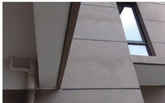
» 常见施工弊病：局部不规则发花
